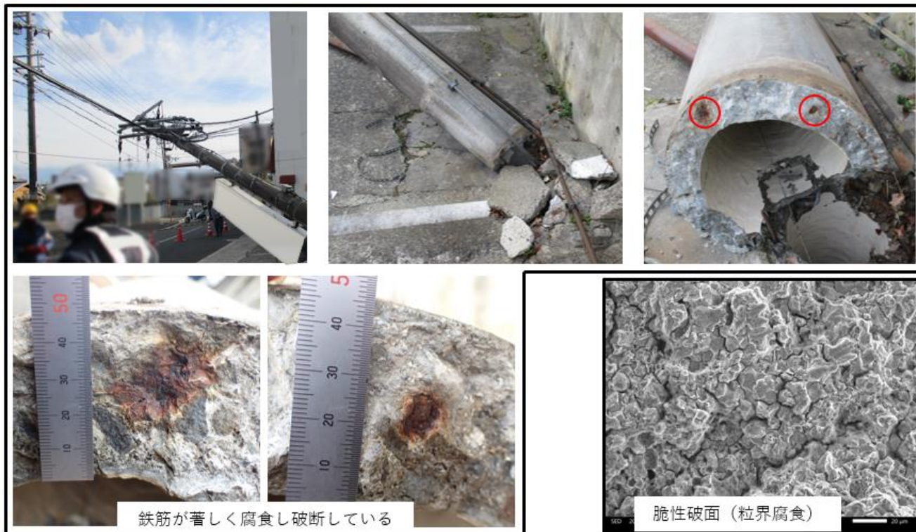
図1 鉄筋コンクリート柱倒壊事故現場 （事例2）
