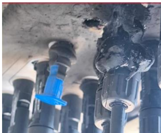
（左）DC コネクタの焼損状況
