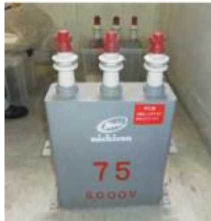
電力用コンデンサー
