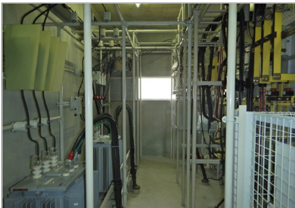
事故が発生した電気室内（写真奥の右側に断路器）
