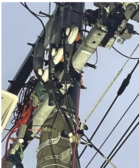
電柱に敷設された高圧引込みケーブル
