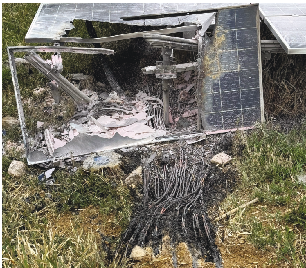
延焼した太陽電池モジュールとケーブル
