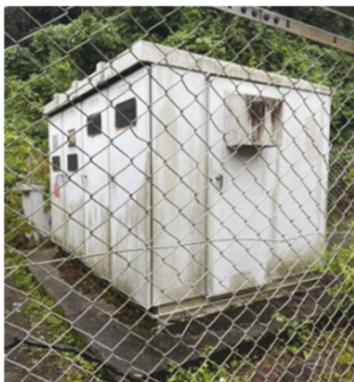
キュービクル設置状況
