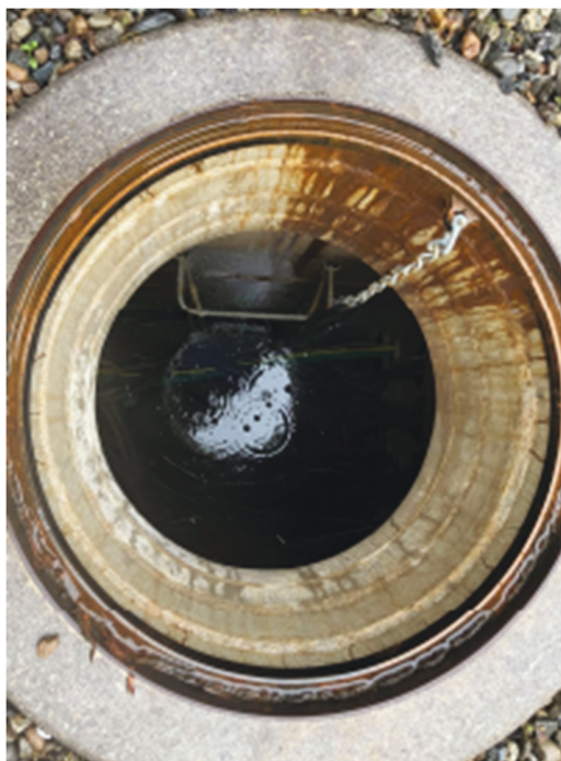
CVT が埋設されていたマンホール
