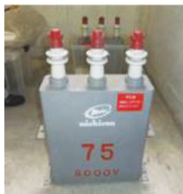
電力用コンデンサー
