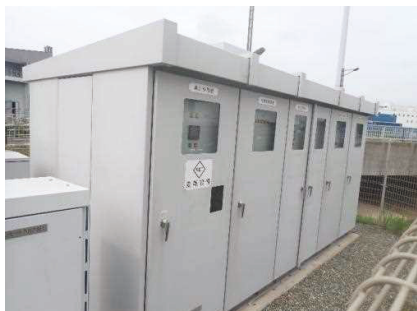
〔図1〕キュービクル（高圧受電設備）
