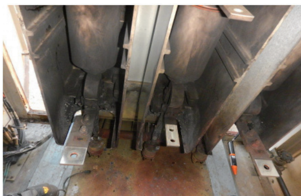
真空遮断器（VCB）上部
