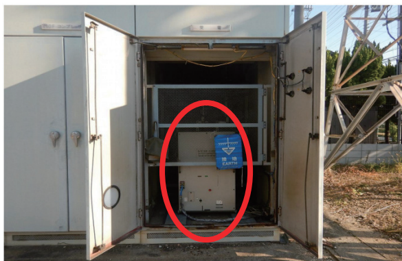
特別高圧受電盤内の真空遮断器（VCB）
