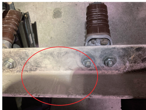
受電用断路器（支持金具）漏水跡
