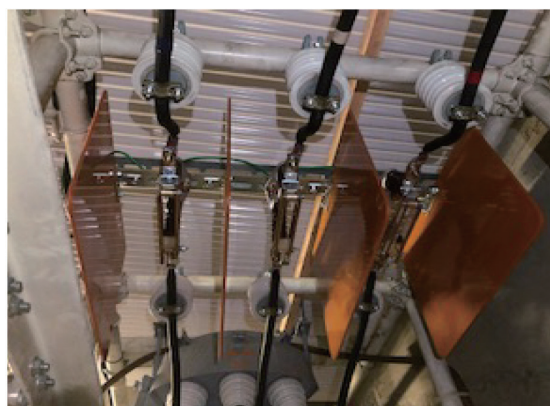
受電用断路器（更新後）
