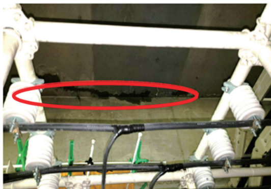
電気室天井漏水跡
