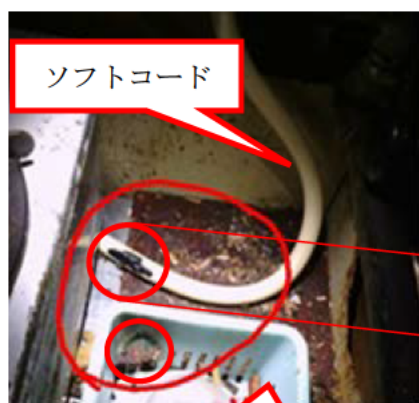
(焼損箇所 (コンロ右側奥の状況))
