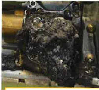
予備ガス栓に樹脂が 付着した状態
