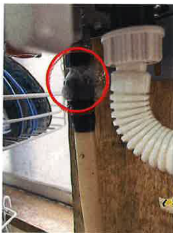
(ガス漏洩箇所)
