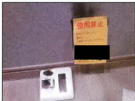
・ガス栓側用禁止状況
