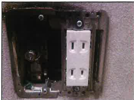
(ガスコードを接続していたガス栓)
