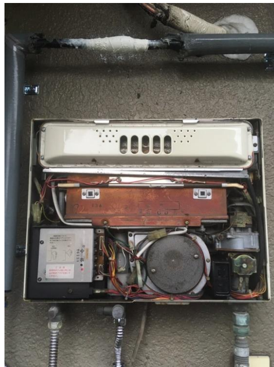
給湯器内部の写真
