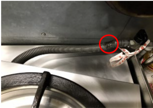
【機器接続具焼損・漏れ箇所】
