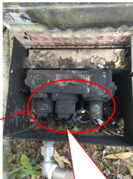
風呂釜内部のバーナー部分が 一部焼損
