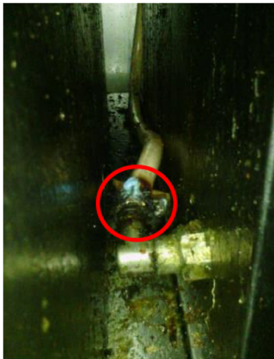
【機器接続具焼損箇所・漏れ箇所】
