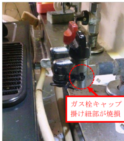
【ガス栓キャップ焼損箇所（未使用側）】
