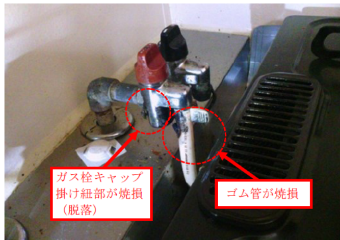
【ガス栓キャップ及びゴム管焼損箇所（家庭用こんろ接続側）】
