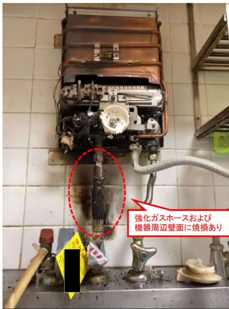
【瞬間湯沸器(前板取外し)、強化ガスホース、機器周辺壁面 焼損状況】
