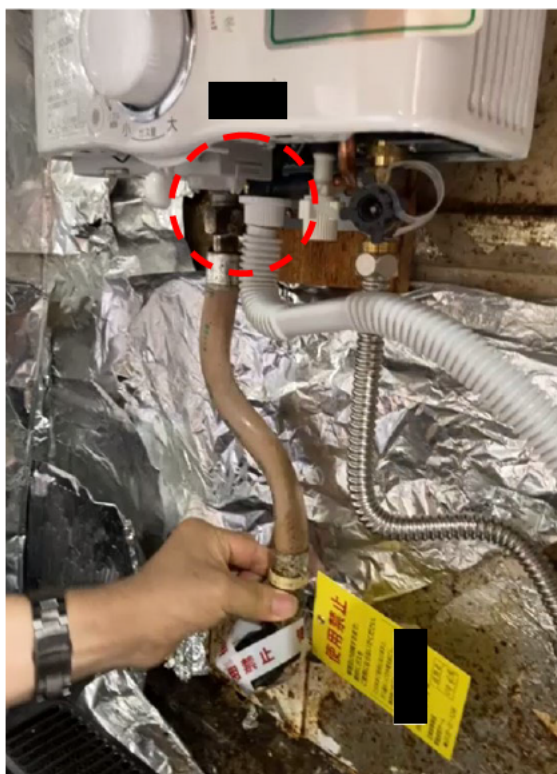
【漏洩箇所：機器接続部】
