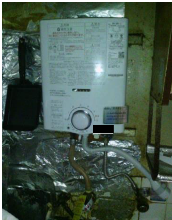
【瞬間湯沸器設置状況】
