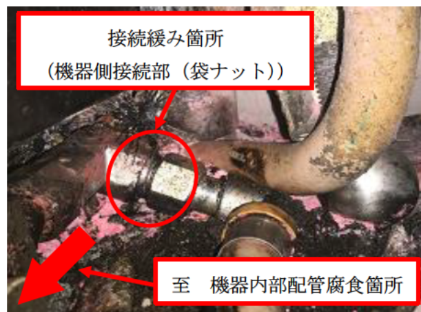
【漏えい箇所（接続具緩み・機器内部配管腐食）】
