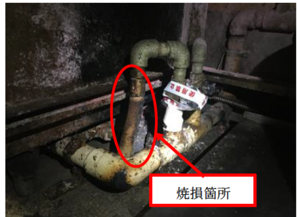
【焼損箇所近景】
