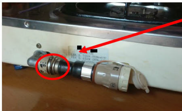
【ガス漏れ箇所及び焼損箇所】
