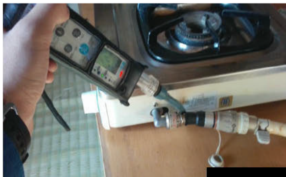
【一口ガスこんろの接続具接続状況】
