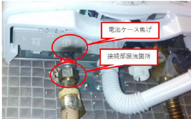
【瞬間湯沸器 電池ケース焼損箇所、漏えい箇所】
