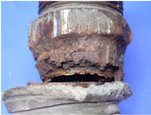
ニップル腐食状況
