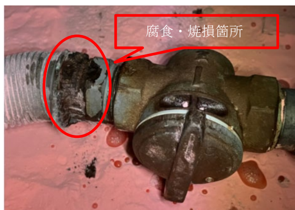
【腐食・焼損箇所】
