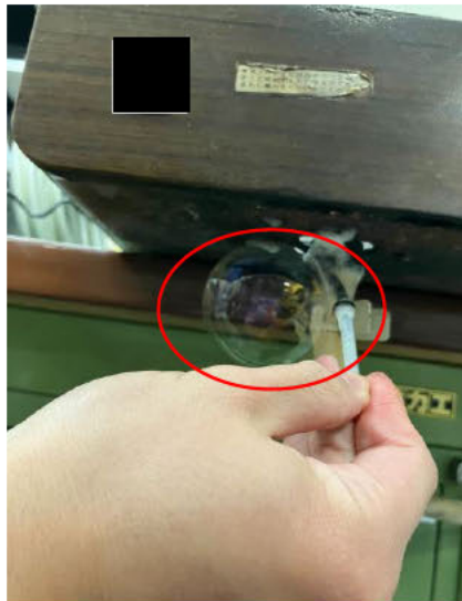
(ガス漏れ箇所)
