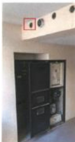
＜給湯器の設置状況(赤枠:排気筒先端)＞
