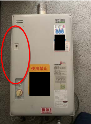
(機器変形箇所)
