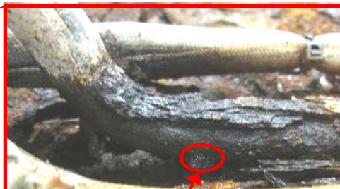
腐食の影響でガス通路部に穴開きが発生 ※発泡液により泡の発生を確認
