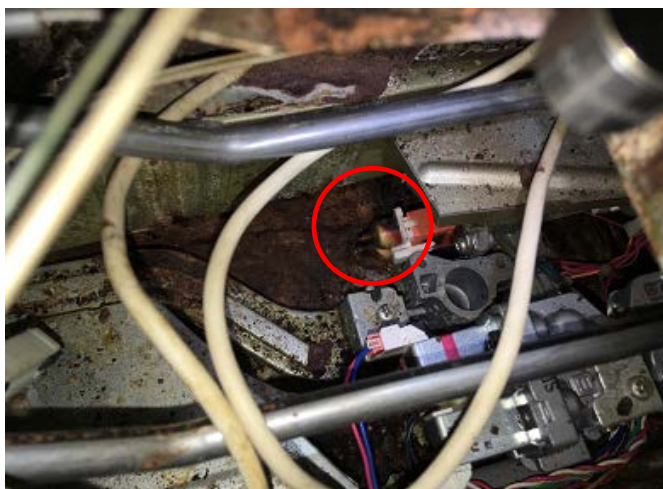
(焼損箇所① (ハーネス部分))
