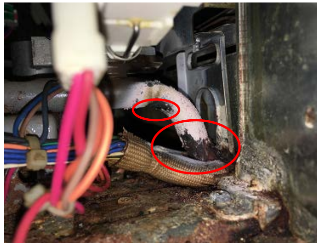
(焼損箇所② (ガス通路部))
