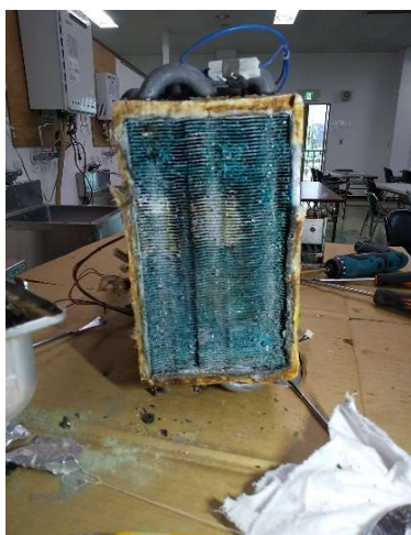
【熱交換器錆 (緑青) 状況】
