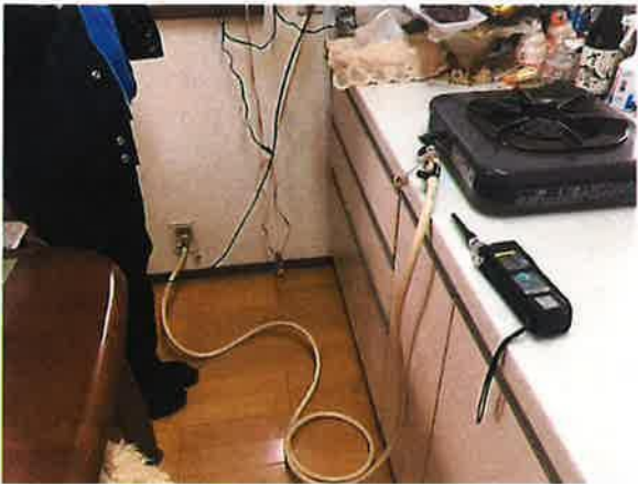
(ガス迅速継手 (機器用ソケット) 焼損状況①)
