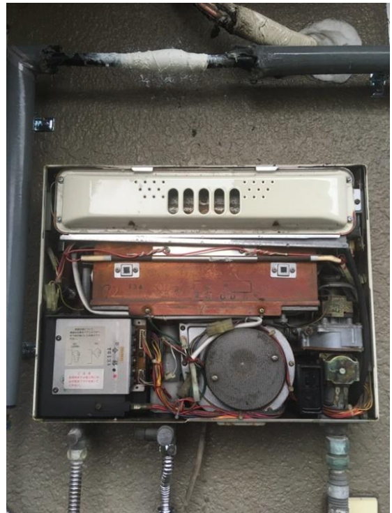
給湯器内部の写真
