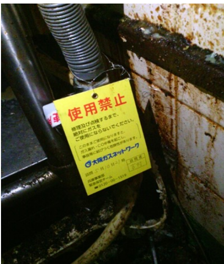
【使用禁止措置】
