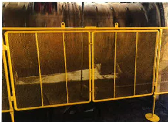
扉を閉じた状態
