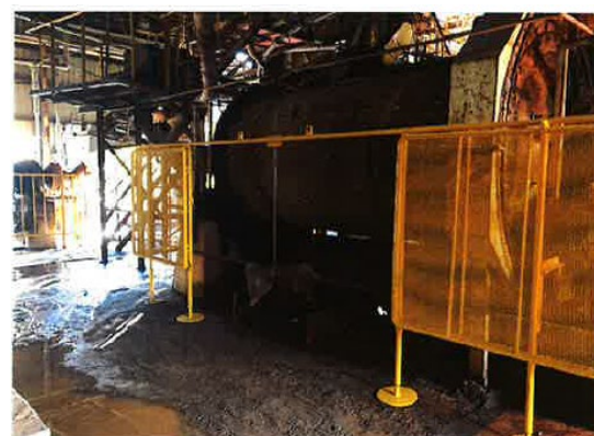
メンテナンス用に扉を開いた状態
