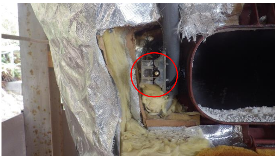
点検窓を開けるとロータリバルブの回転が停止
