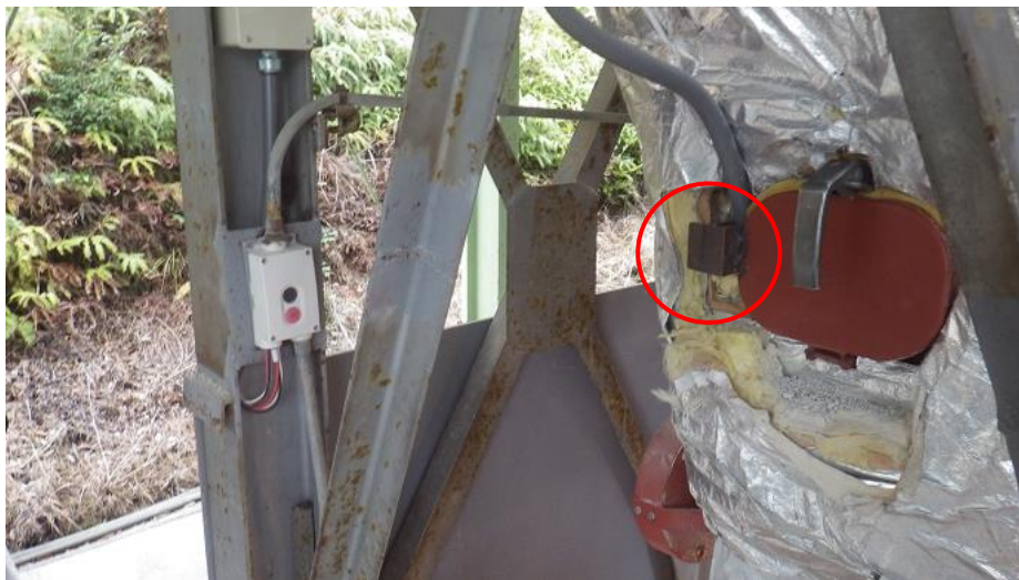
点検窓の開閉部にリミットスイッチを設置
