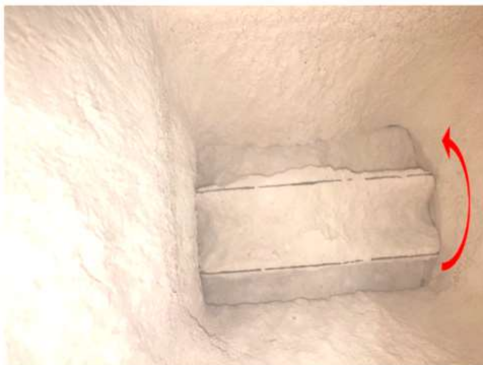
写真4：点検窓内部（ロータリーバルブの羽）
