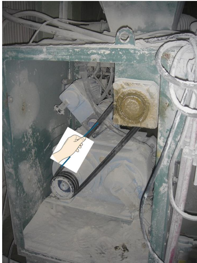
現場写真（肥料袋詰め機スクリーコンベア駆動部Vベルト）
